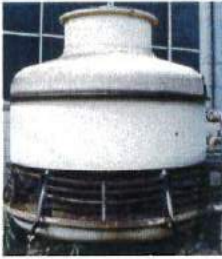
かなり古いクーリングタワー(CT)
