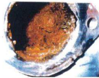
化学洗浄後の配管内部の状態
