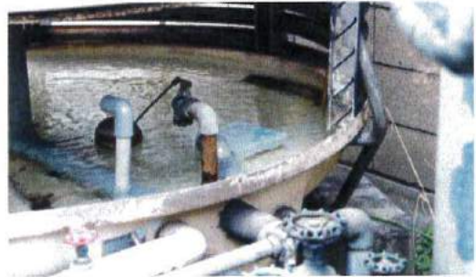
“BS21”使用后3ヶ月使用后CTの状態 “BS21”投入直後に配管内より“浮き錆”が剥離され、すごい赤水状態となった。この状態は、しばらく続き、2回水を張り替えた結果赤水は出なくなった
