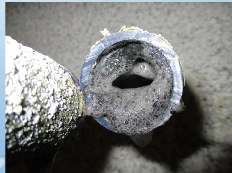
実際の配管内洗浄中汚れ
